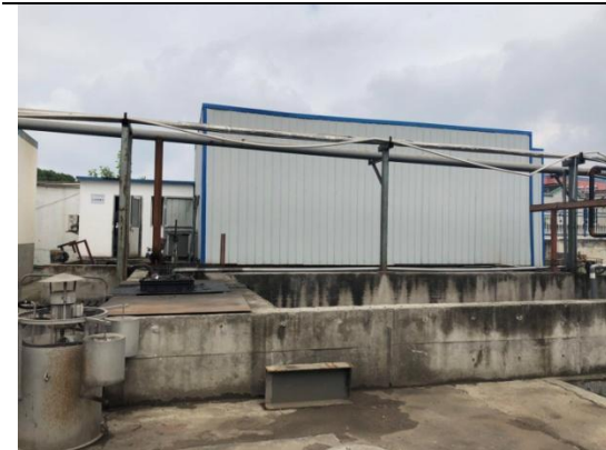
事故应急池/初期雨水收集池
