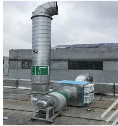
3#食堂油烟排气筒及治理设施:
