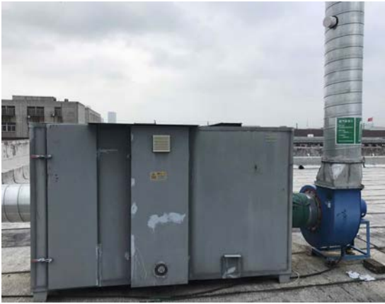
2#印刷、固化、网版擦拭排气筒及治理设施:
