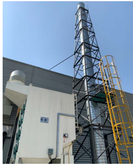
FQ-03 排气筒及其治理设施（滤筒式除尘器）
