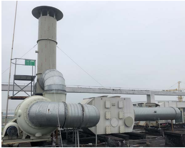
FQ-01 排气筒及其治理设施（活性炭吸附）
